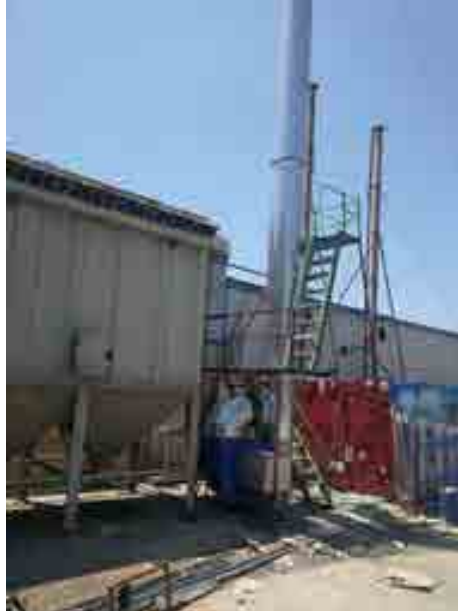
图5 抛光工序废气排气筒及布袋除尘器
